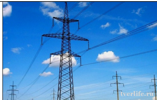
-высоковольтные линии электропередач
